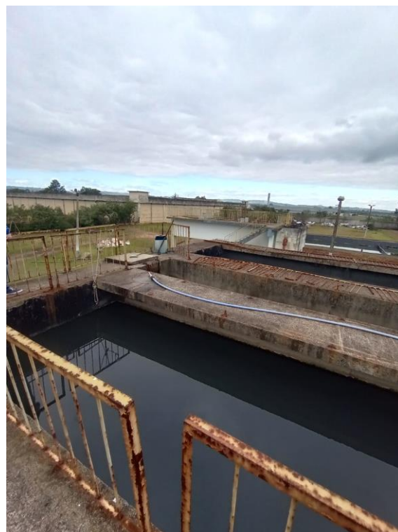
Imagem 14: Estrutura do UASB
