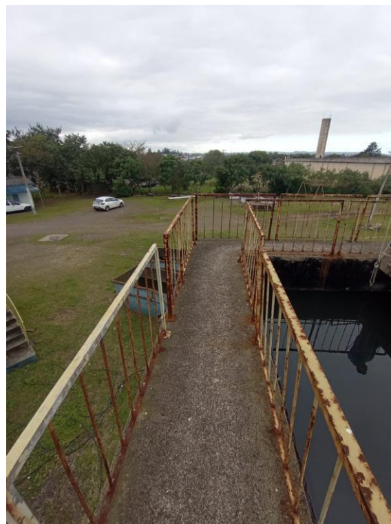
Imagem 12: Estrutura do UASB
