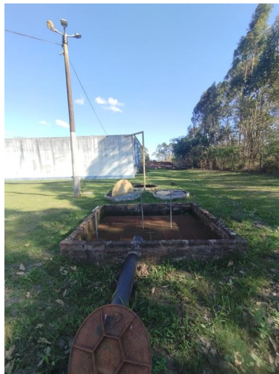
Imagem 16: Poços e caixa de manobra 2
