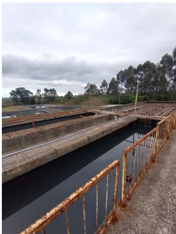
Imagem 13: Estrutura do UASB
